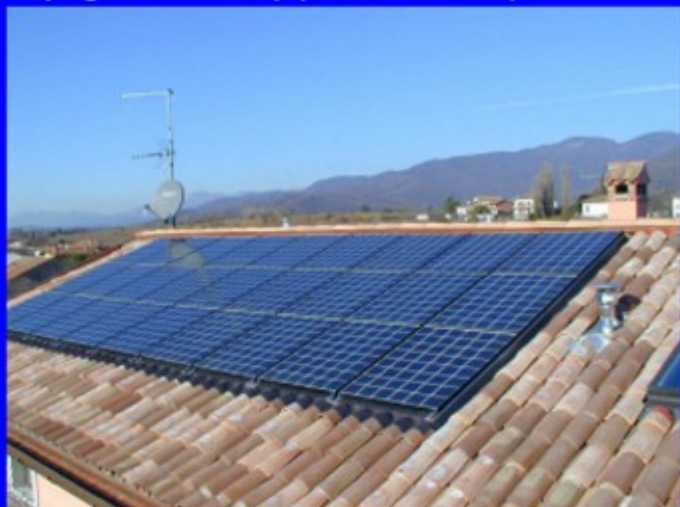
Integrato con recupero termico da 2975+1750 Wp (Cividale del Friuli)
